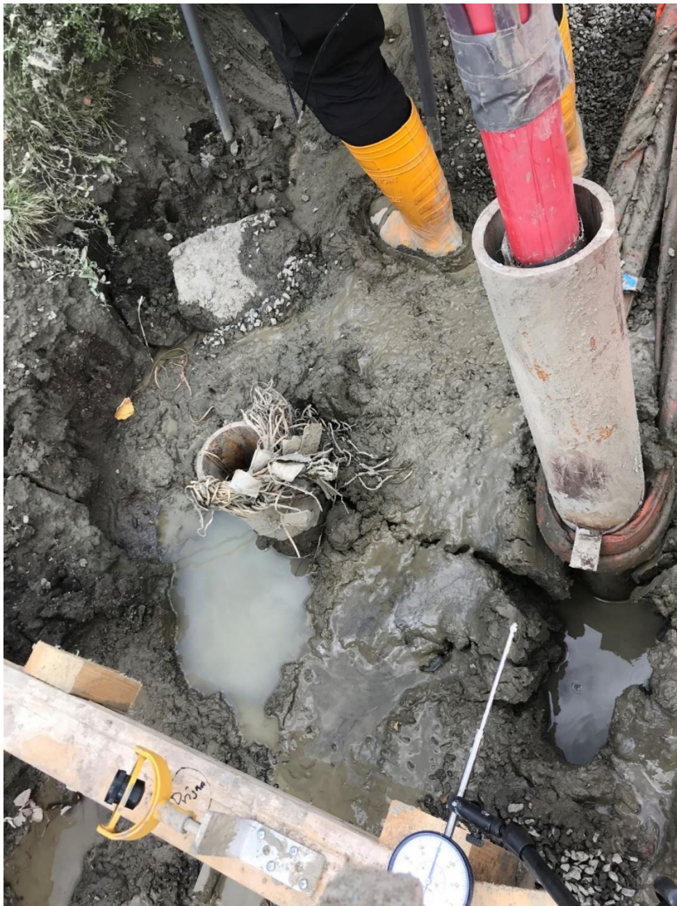
Figur 109: Belastning av Påle 2, här ses även spricka mellan Påle 1 & 2
